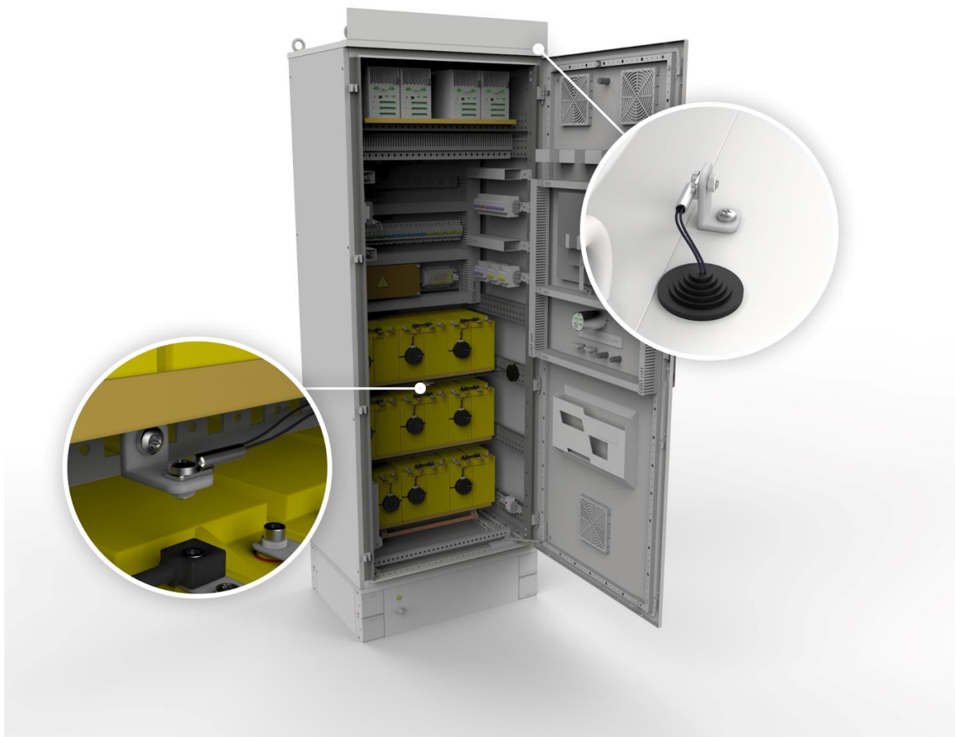
Рисунок В.5. Внешний вид шкафа с установленными датчиками Репей
